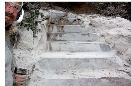
Les marches du futur sentier « les balcons volcaniques » au départ de Péirigous sont construites (cf. PL n°10)
